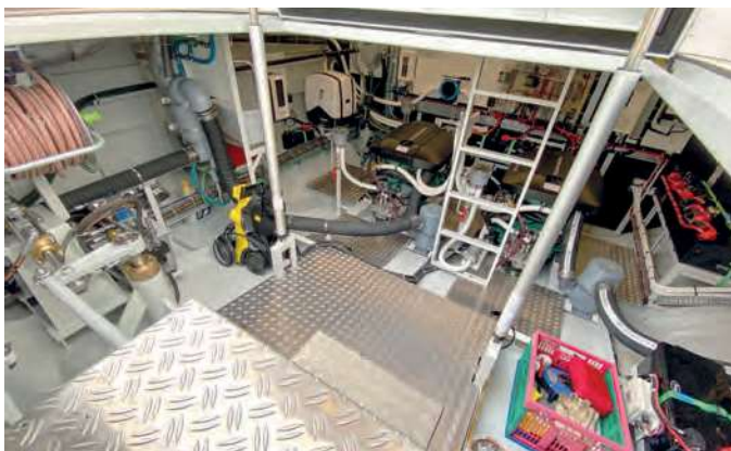
Ein Maschinenraum, der Technikfreaks das Herz höherschlagen lässt. Perfekt ausgestattet und servicefreundlich, die Installation der beiden Volvo Penta-Dieselaggregate D3-150.
